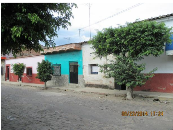
IMAGEN QUE EXPRESA LAS CONDICIONES FISICAS EN REGULAR ESTADO DEL EMPEDRADO EN LA VIALIDAD/VP FRANCISCO I. MADERO.
