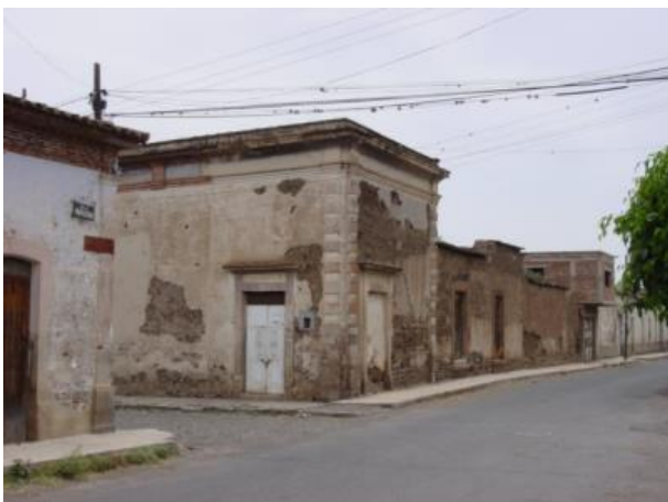
EN LA PARTE SUPERIOR IZQUIERDA; INMUEBLE EN REGULAR ESTADO.
