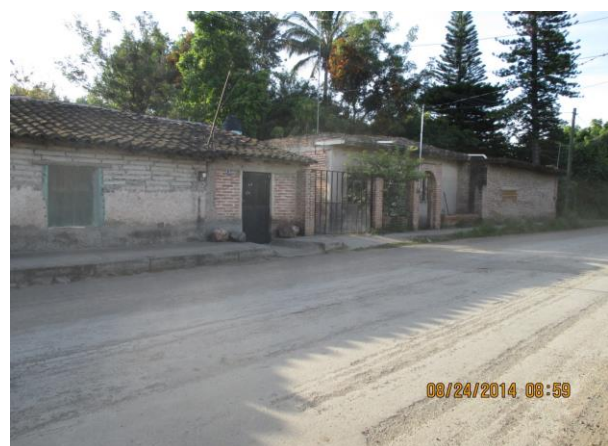
IMAGEN QUE EXPRESA LAS CONDICIONES FISICAS EN REGULAR ESTADO DEL ASFALTO EN LA VIALIDAD/VP IREFORMA EN LA LOCALIDAD DE SAN JOSE DE GRACIA.
