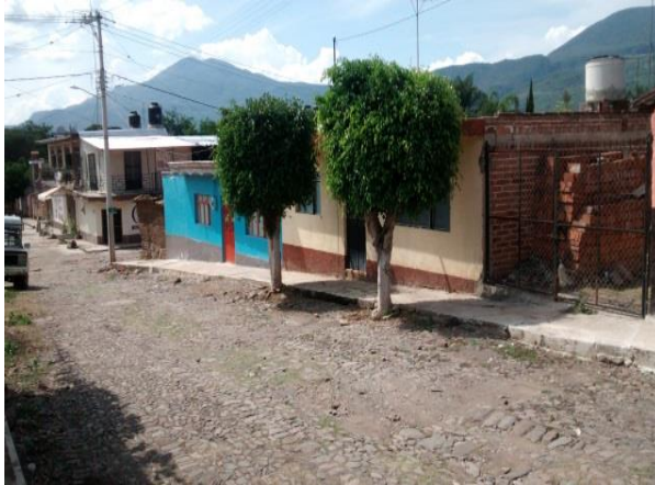
IMAGEN QUE EXPRESA LAS CONDICIONES FISICAS EN MAL ESTADO DEL EMPEDRADO EN LA VIALIDAD/VP VICENTE GUERRERO DE LA LOCALIDAD DE CITALA.
